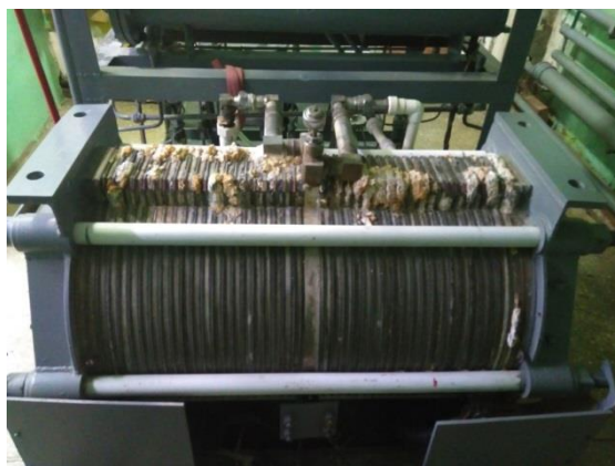
Рисунок 1. Электролизер установки «КРАБ»
